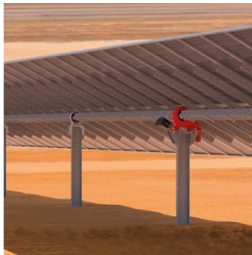
Figura 3 - Inseguitori solari monoassiali
