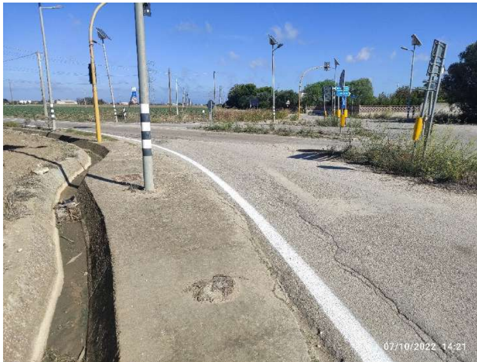
Figura 32: Interferenza n.19 con sottoservizi da identificare
