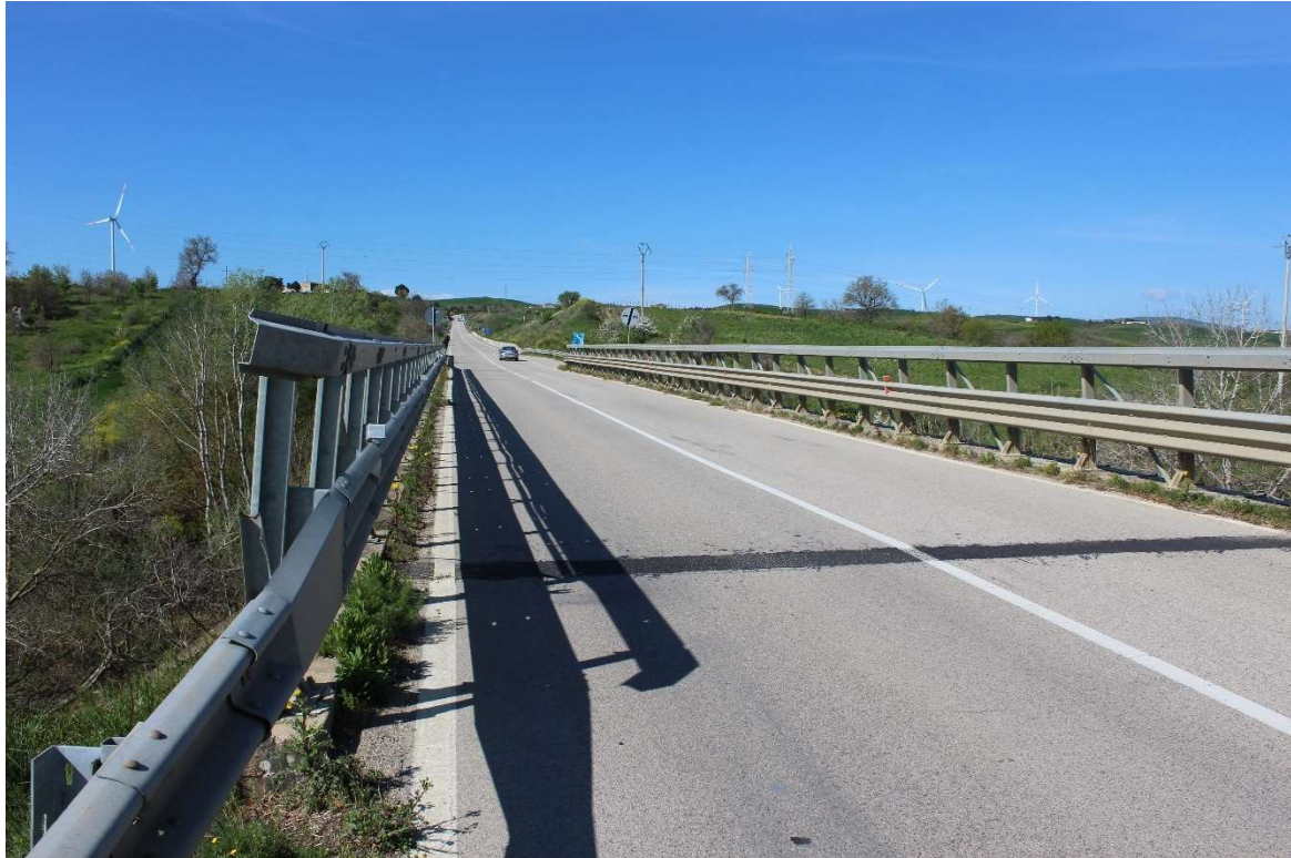
Figura 21 Attraversamento del cavidotto su ponte sul fiume Bradano
