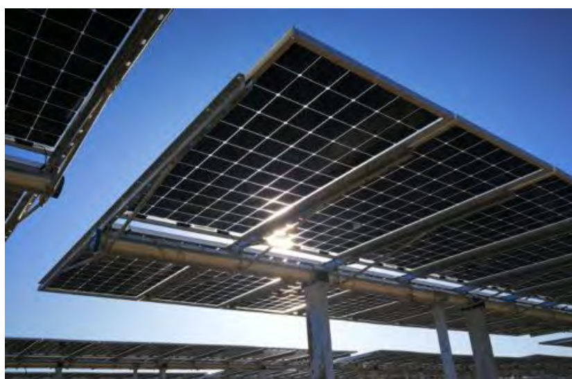
Figura 2.42 Esempio di struttura a tracker monoassiale
