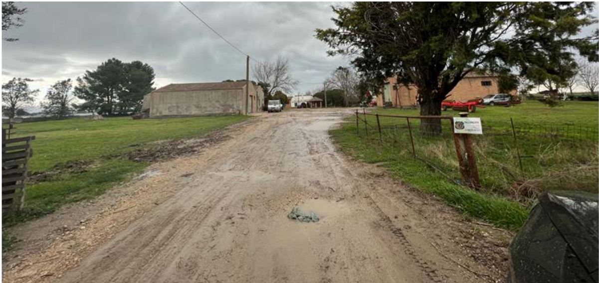
Viabilità esistente con pavimentazione naturale in pessimo stato
