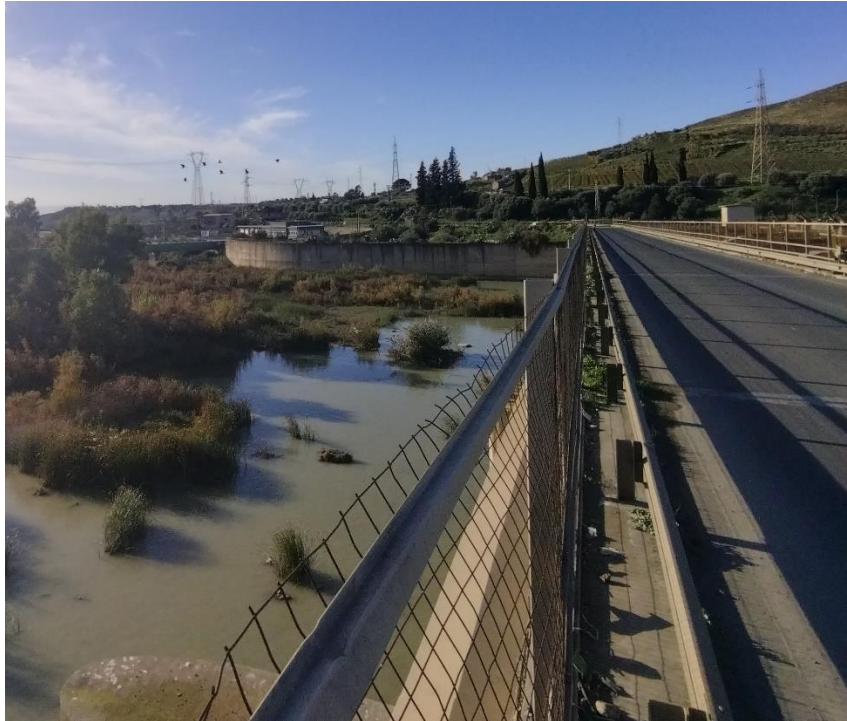
Figura 26 – Tracciato del cavidotto che attraversa il Fiume Simeto all'altezza della Diga di Ponte Barca
