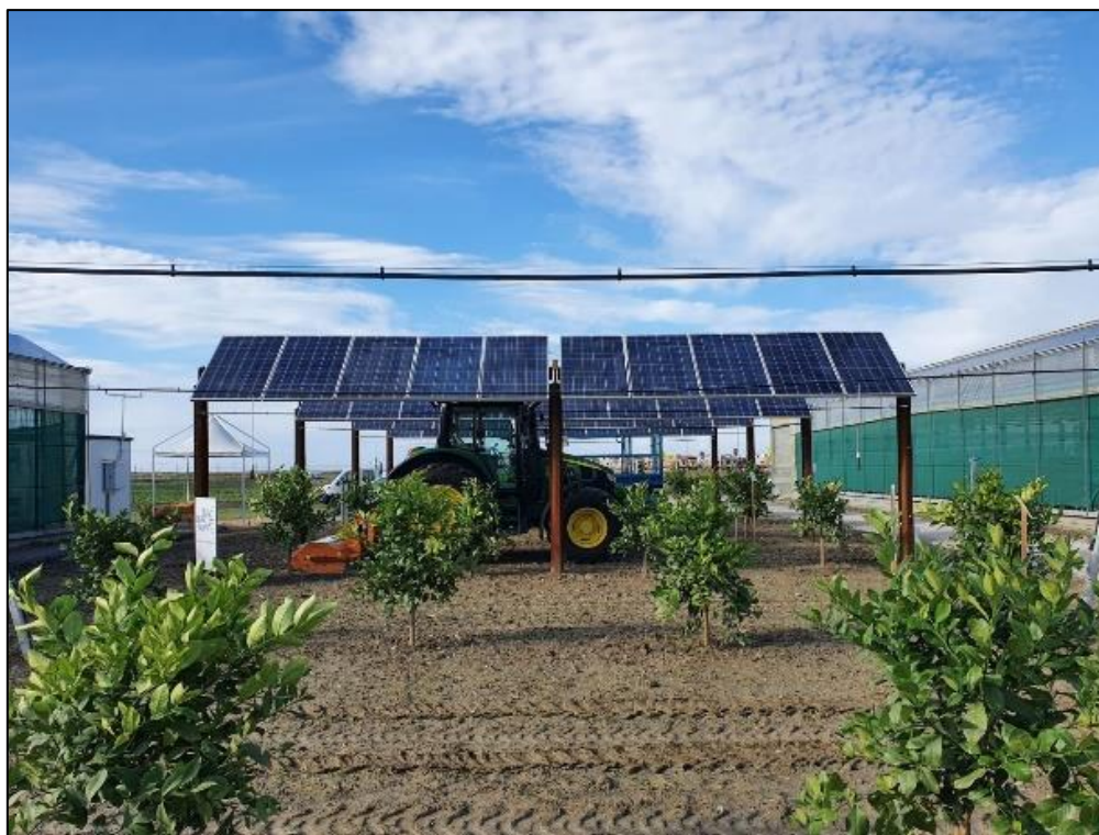
Figura 4: Impianto dimostrativo realizzato nel complesso agrivoltaico di Scalea (CS) gestito dal Consorzio Le Greenhouse.
