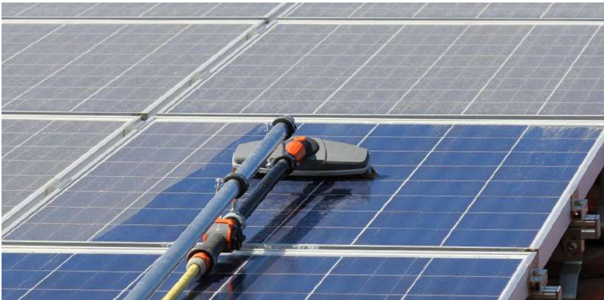
Figura 25- Esempio pulizia pannelli fotovoltaici
