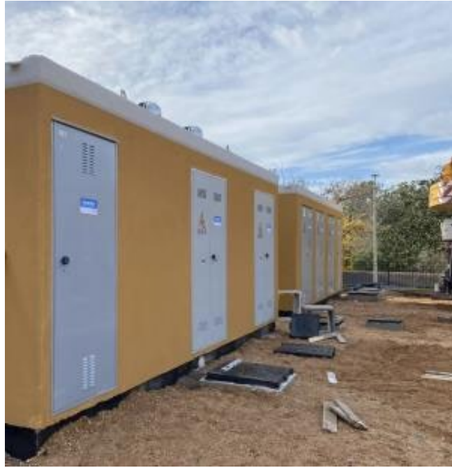
Figura 8: esempio di cabina in C.A.V.. La parte nera costituisce la vasca di fondazione e raccolta cavi, che sarà interrata.
