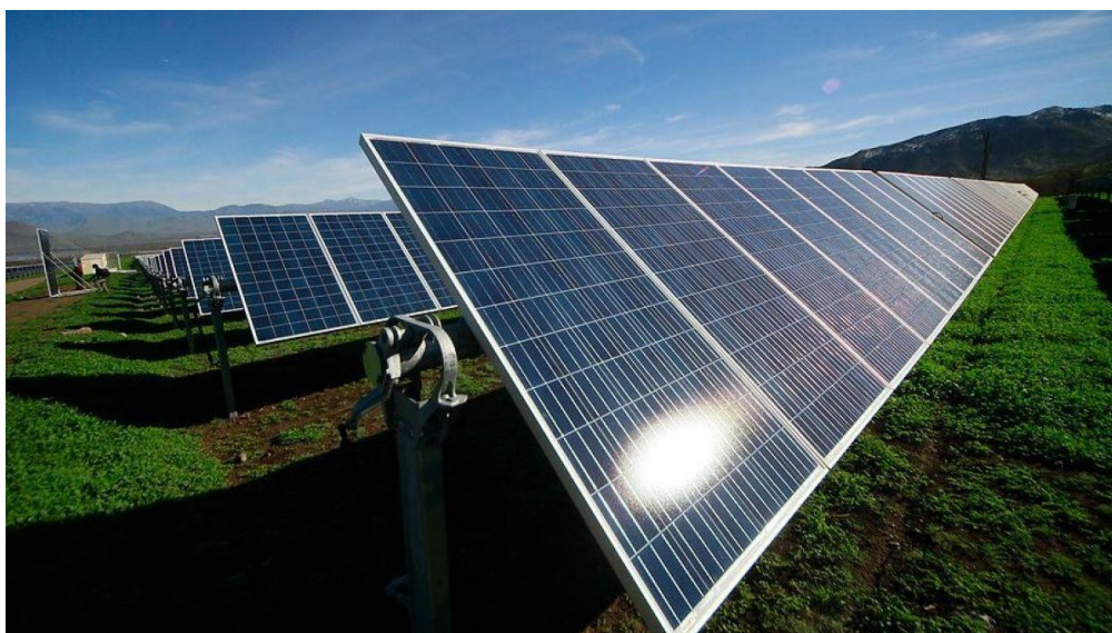
Figura 17: trackers tipo con pannelli installati.
