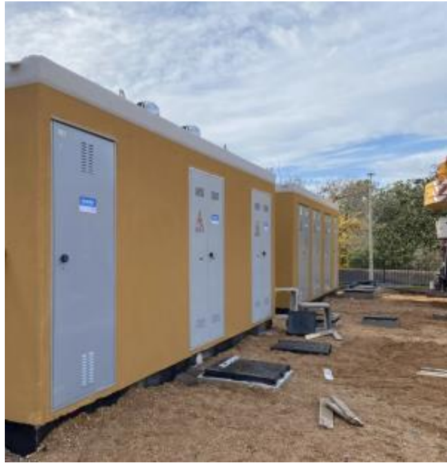
Figura 22: esempio di cabina in C.A.V. La parte nera sottostante la cabina costituisce la vasca di fondazione e raccolta cavi, che sarà interrata.
