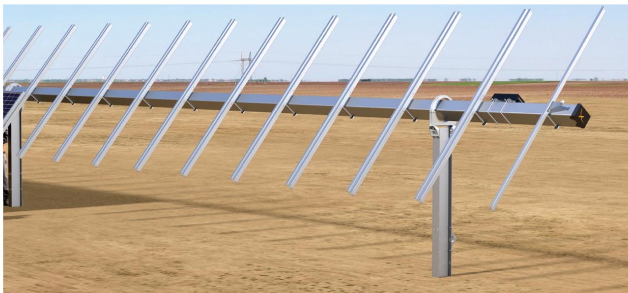
Figura 16: struttura tipo di sostegno dei trackers.
