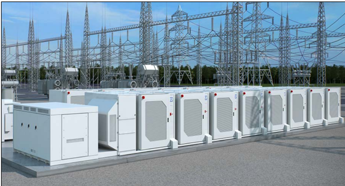
Figura 35: esempio di sistema di stoccaggio per impianto fotovoltaico - Gridstack
