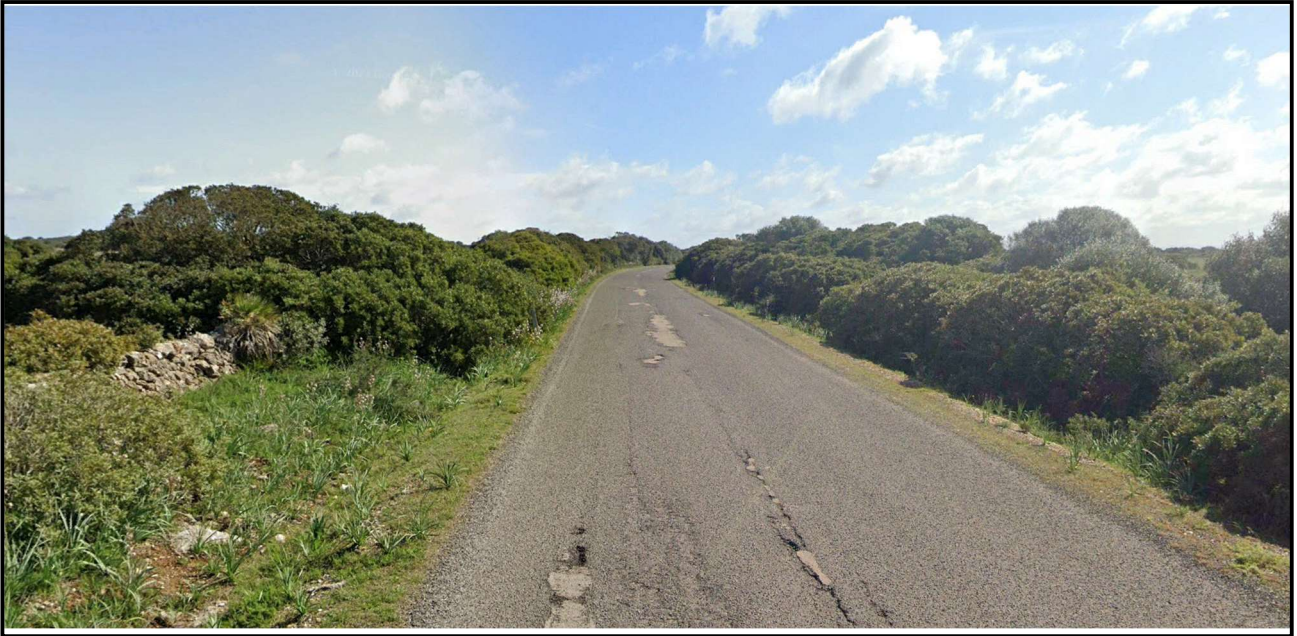
Figura 25 – Foto 8 (Strada SP65)
