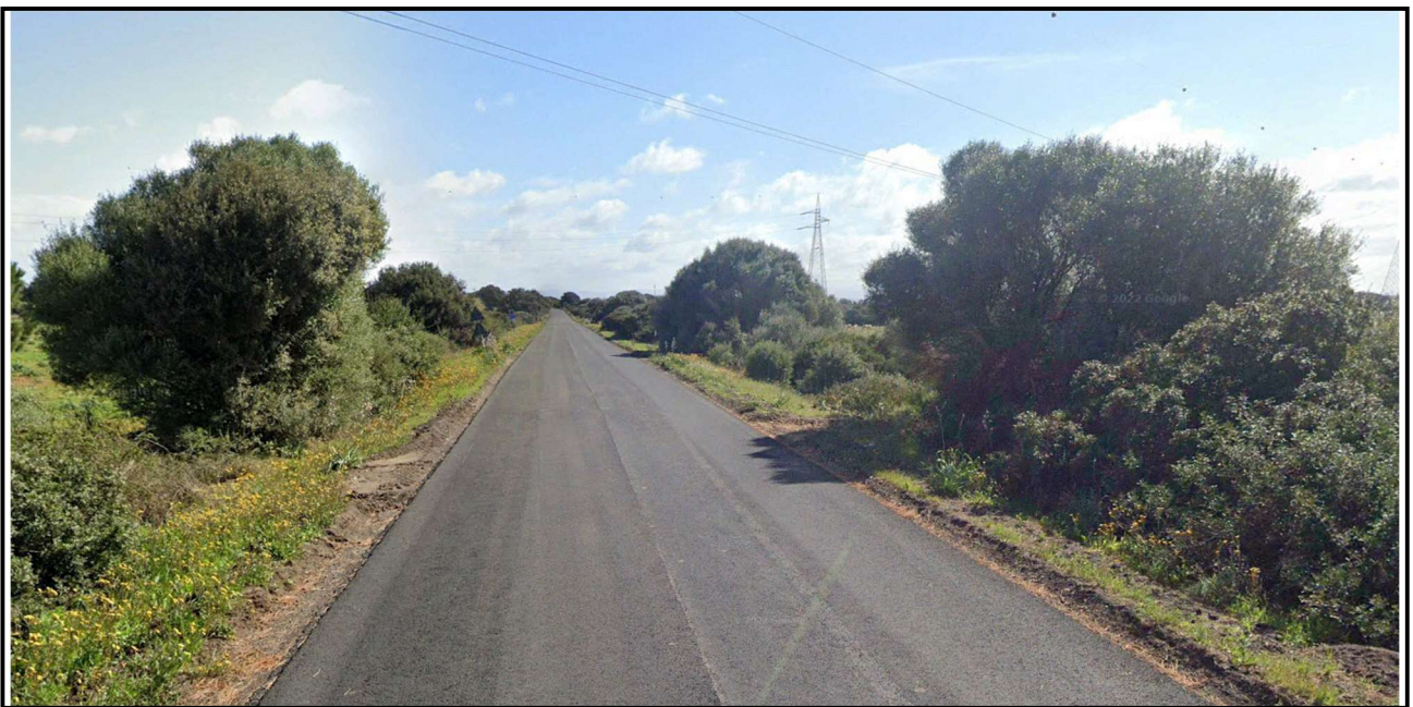
Figura 28 – Foto 11 (Strada SP65)
