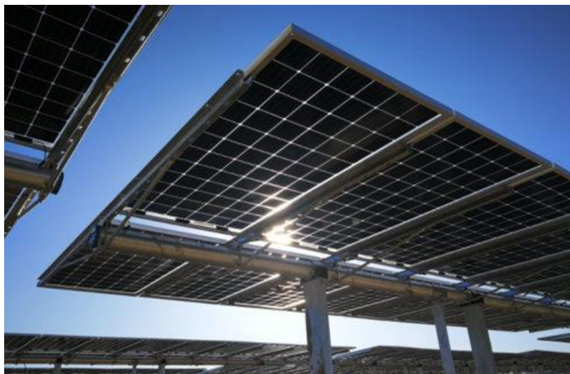
Figura 3.2: Esempio di struttura a tracker monoassiale.
