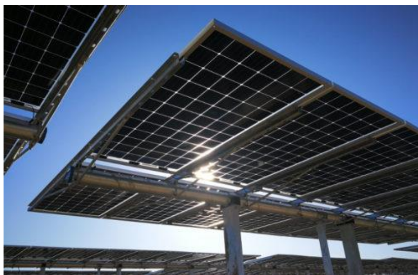
Figura 2.8 Esempio di struttura a tracker monoassiale
