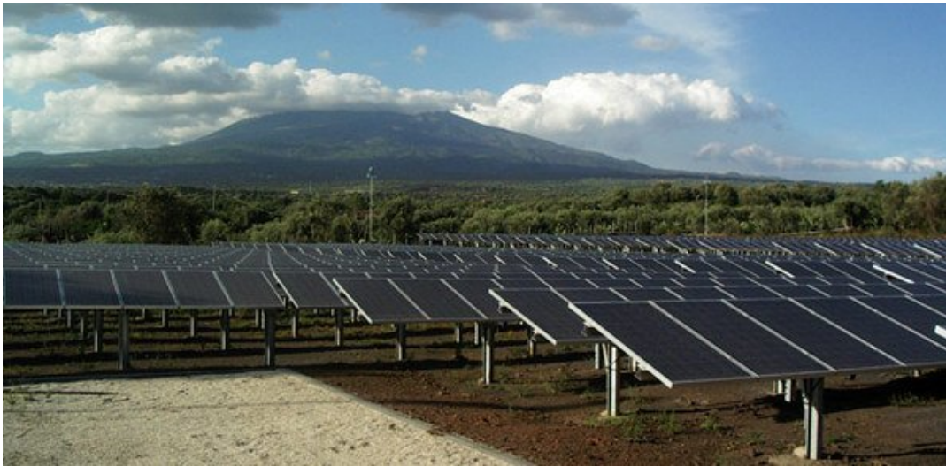
Figure 6-2 strutture fisse con pannelli
