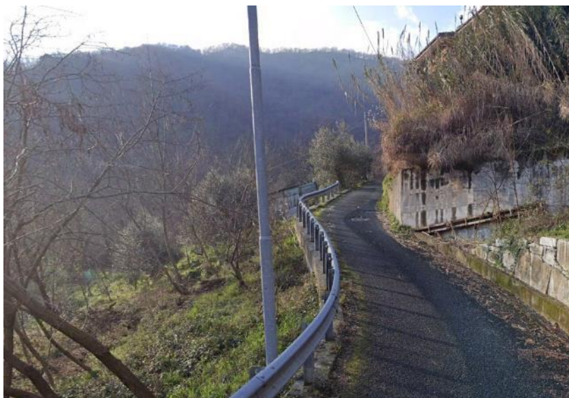
Foto 9 – Muro in pietrame e muro in cls con tiranti in corrispondenza del coronamento del dissesto.
