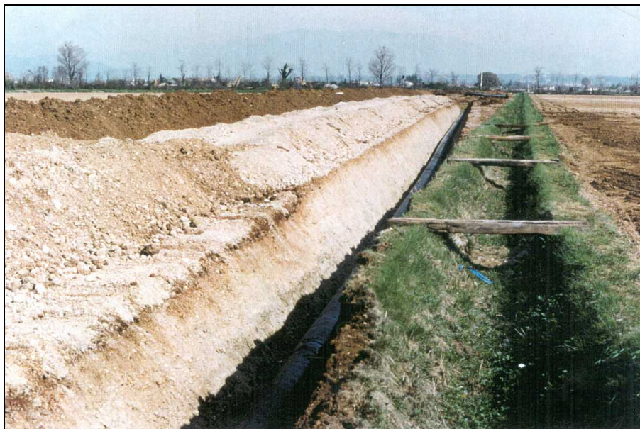
Foto 3-H: Tratto di condotta posata, si nota l'accantonamento dello strato humico separato dal materiale di scavo della trincea
