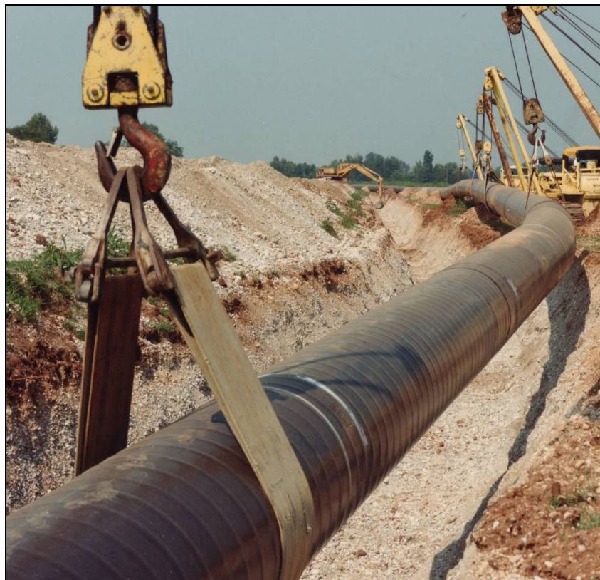
Foto 3-G: Posa della condotta (esempio di condotta con diametro superiore alla linea in progetto)
