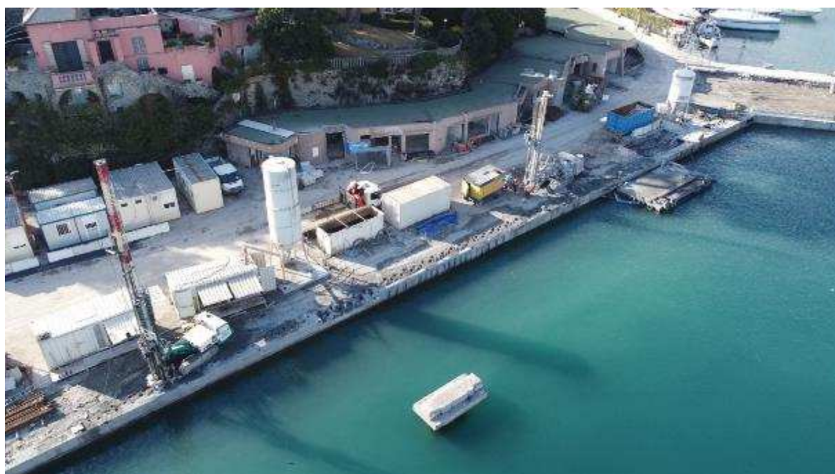
Foto 14: 03.03.2023 - vista di dettaglio da drone della banchina piazzale (in corso l'esecuzione dei tiranti e il consolidamento con jet-grouting)
