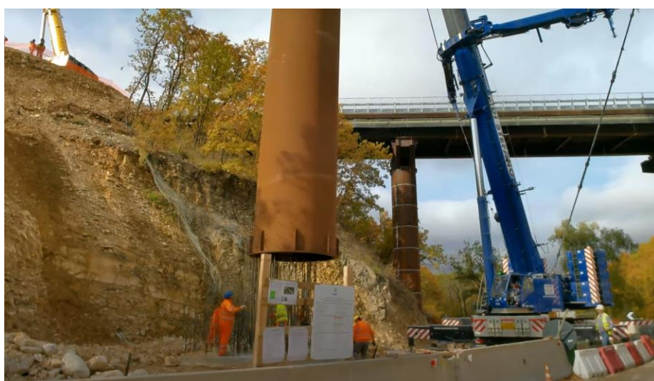
Figure 3. Posizionamento del guscio metallico in COR.TEN tramite gru, con evidenza delle armature di attesa dal plinto.
