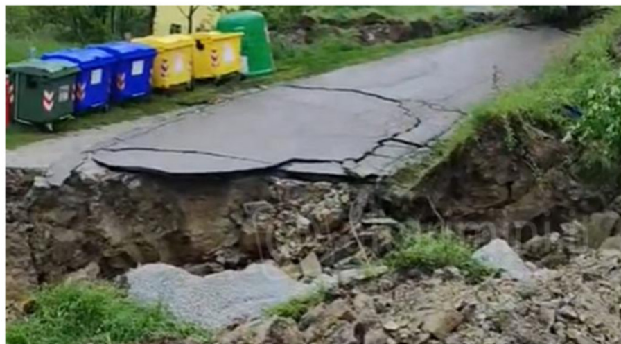
Figura 20 – Immagine di dissesto a causa dell'alluvione del Maggio 2023 che ha colpito la Romagna
