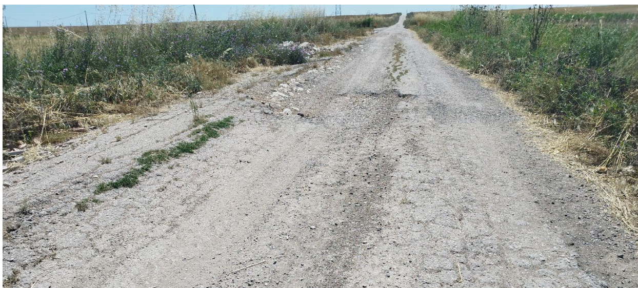
Viabilità in conglomerato bituminoso esistente in pessimo stato
