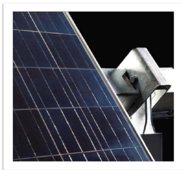
Figura 6.4. – Strutture di sostegno dei moduli fotovoltaici.
