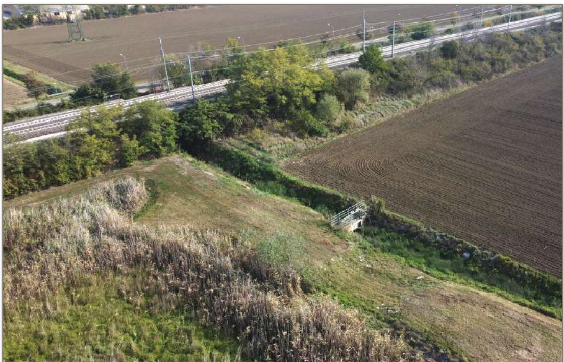
Figura 7: Vista sulla Fossa Galli in corrispondenza della tombinatura di attraversamento della Linea FS
