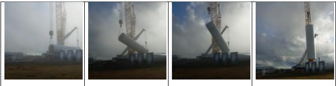
Figura 5.30 – Schema delle fasi di sollevamento dei componenti dell'aerogeneratore (Fonte sito web http://www.windfarmbop.com/ )
