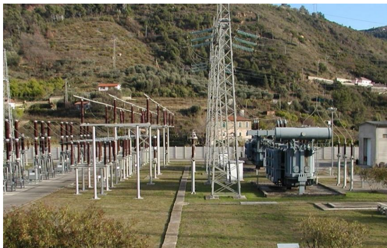
Figura 1.2: Esempio di sottostazione di trasformazione
