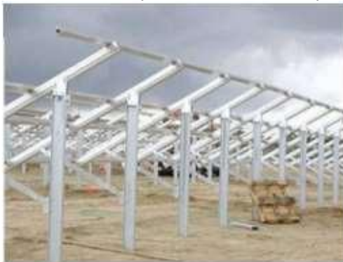
FIGURA 4 - STRUTTURE DI SOSTEGNO (TRACKER)
