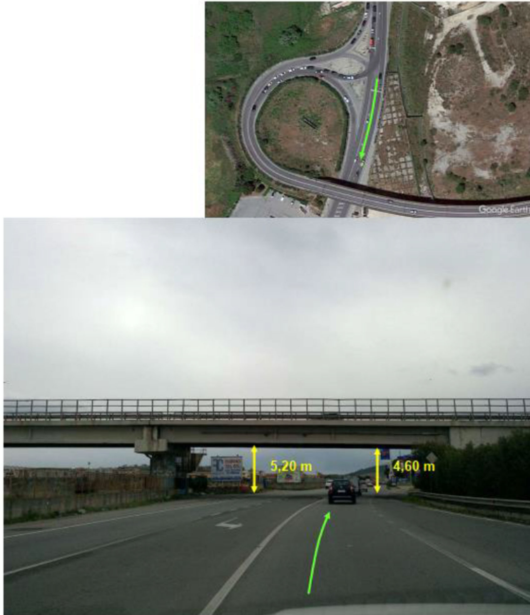
Fig.28- Ostacolo luce libera ponte su SS106
