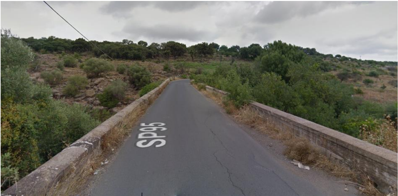
Immagine 24: Primo tratto di strada interessato dall’attraversamento di un piccolo ponticello sulla strada provinciale SP95
