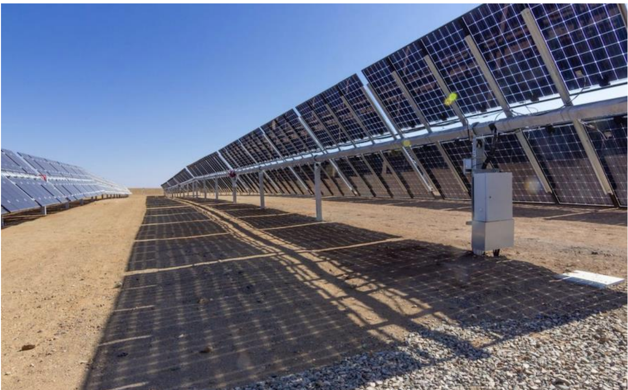
Figura 69 – Particolare strutture di sostegno impianto del tipo ad inseguimento monoassiale
