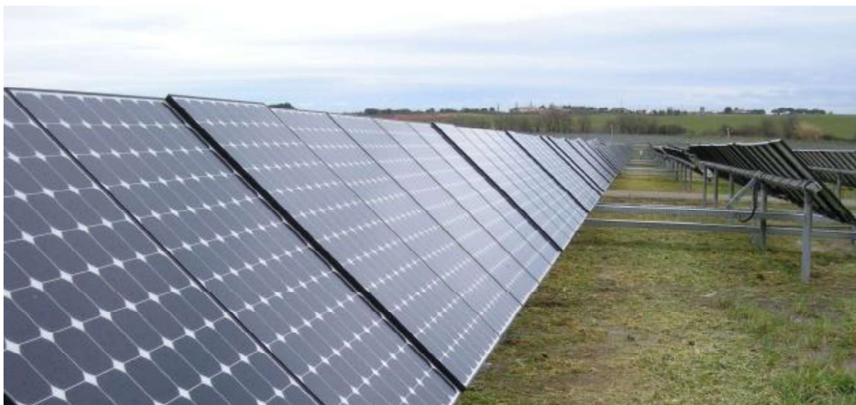
Figura 10 -Stato del terreno inerbito sotto i pannelli fotovoltaici
