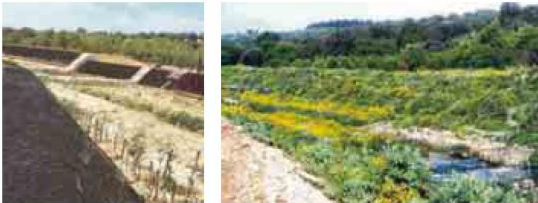
Figura 7 - Sponde di una fiumara rivestite con geostuoia tridimensionale rinforzata erinverdata.
