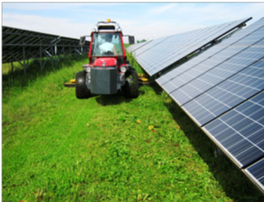
Lavorazione delle macchine agricole su campo agrivoltaico
