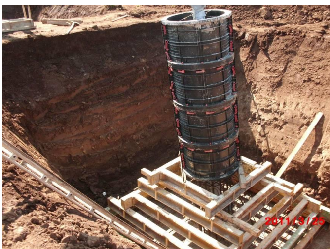
Figura 5: Realizzazione di fondazioni superficiali tipo CR per un sostegno a traliccio. Nell'immagine si può osservare la fase di casseratura
