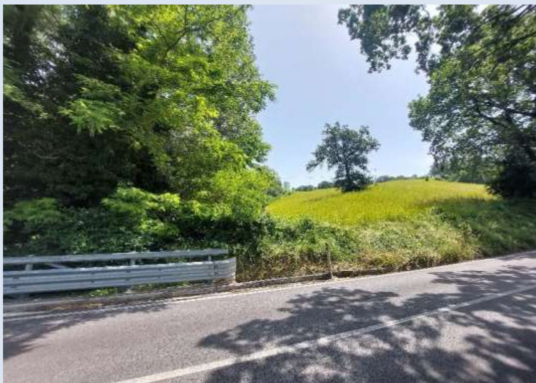
Foto 9 | Versante in dissesto, perimetrato dal PAI, in dx del Fosso Pisciarelle
