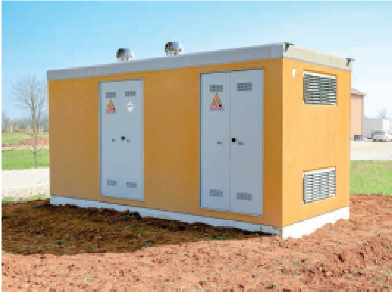
Figura 5.1 Vista Cabina quadri AT
