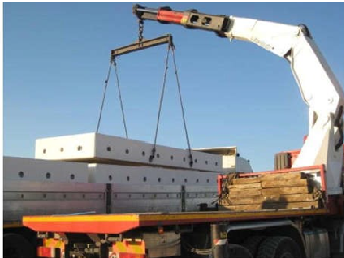
Figura 26 | Scarico cabina trasformazione
