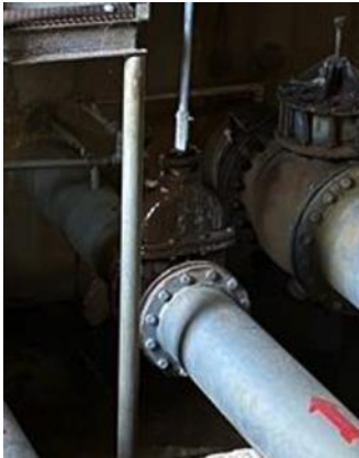
Figura 7 - Saracinesca ammalorata nella camera di manovra del serbatoio SS1
