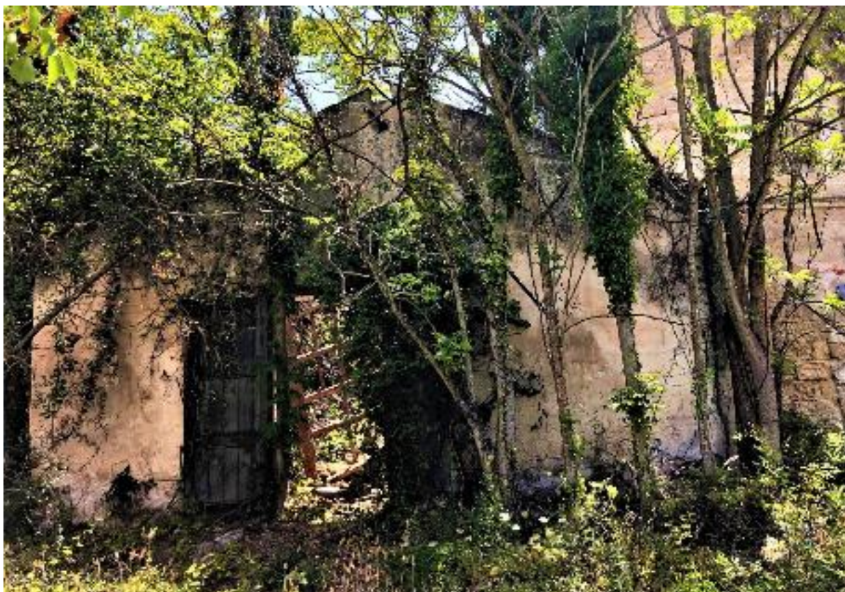
Figura 47. Masseria Buffoluto a S della Chiesa di Santa Barbara. L'edificio è oramai un rudere invaso da folta vegetazione.
