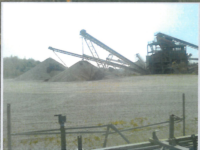
69 - Impianto di frantumazione
