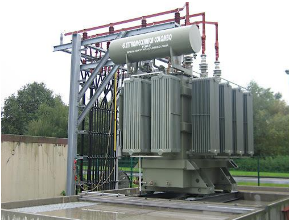
Figura 4_immagine qualitativa Trasformatore di potenza
