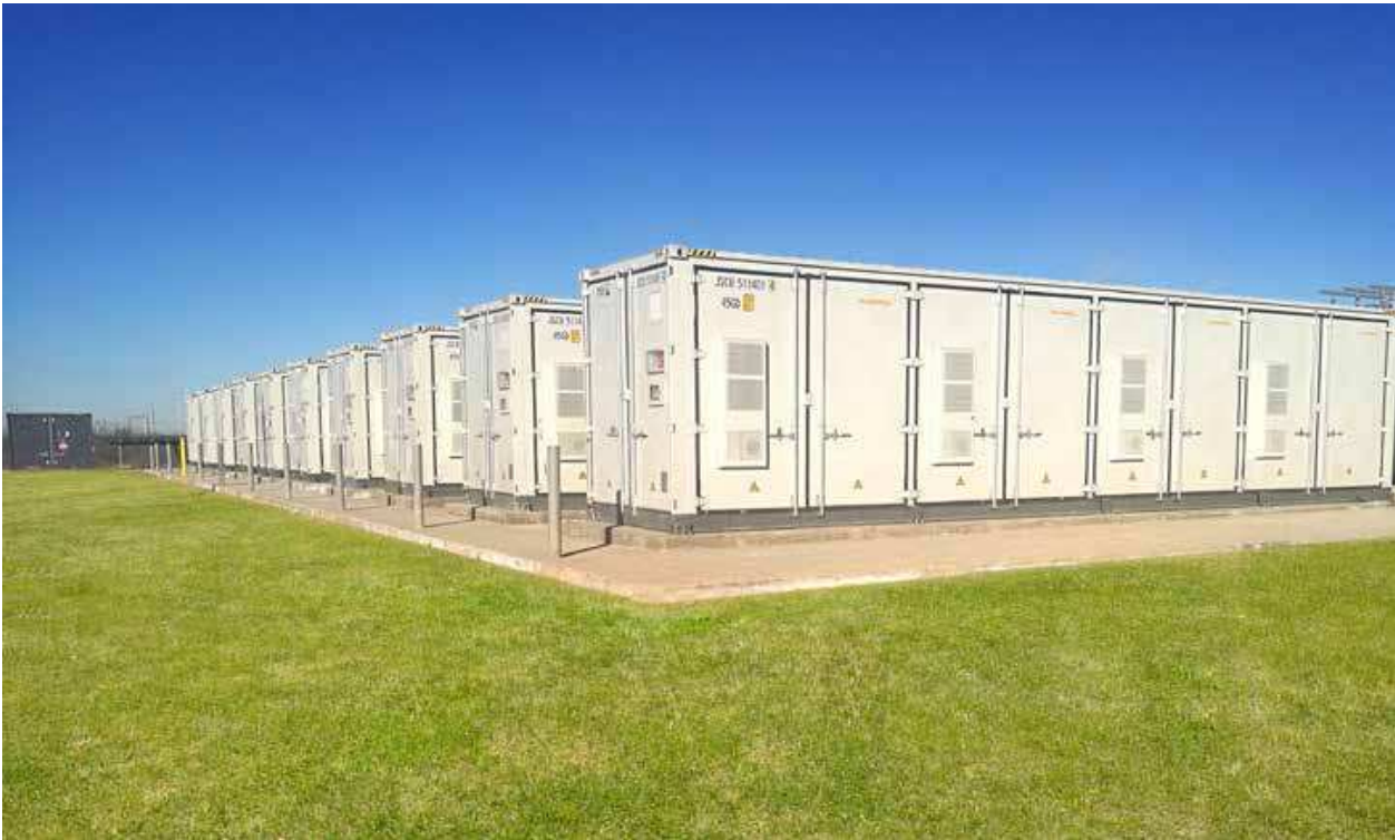
Figura 3. Esempio container di accumulo climatizzato del tipo ISO 20ft e capacità di circa 1,5 MWh
