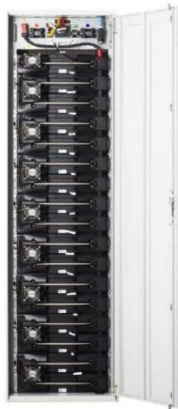
Figura 10c. Esempio rack batterie
