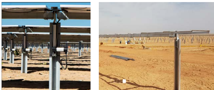
Figura 5 - Particolare strutture ad inseguimento ed attuatore
