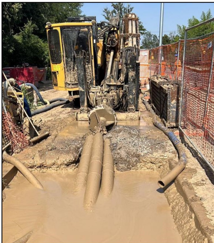
Figura 3.22: Realizzazione elettrodotto interrato. Fase di scavo mediante trivellazione orizzontale controllata (immagine d'archivio)
