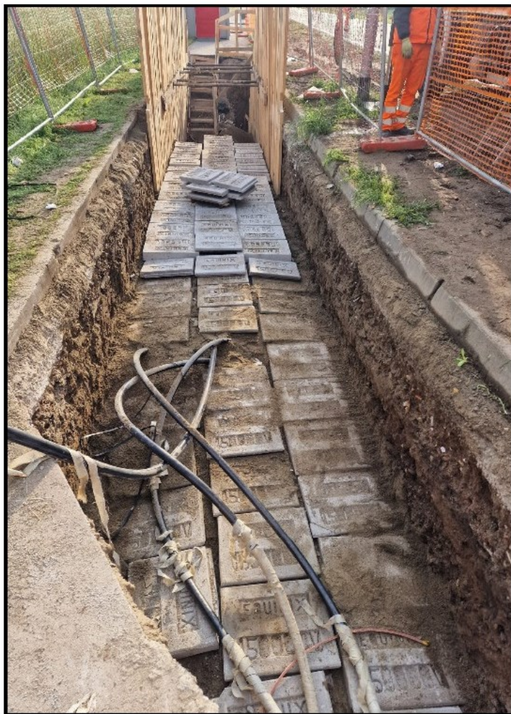
Figura 5.20: Realizzazione elettrodotta interrato. Fase di predisposizione buca giunti cavi AT – posa elementi cls di sicurezza (immagine d’archivio)
