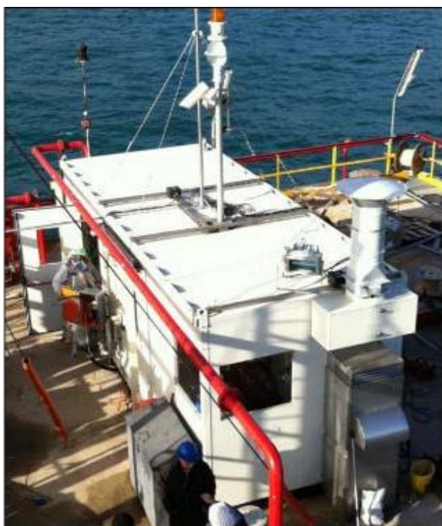
Figura 21 - Esempio Control room Terminale
