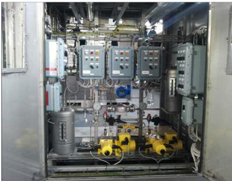
Figura 40 - Sistema di Odorizzazione
