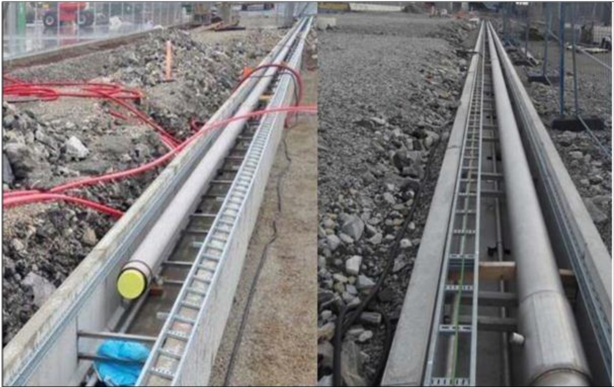
Figura 22 - Impianto di Risavika (Norvegia) - Cunicolo di passaggio tubazioni tipo VIP
