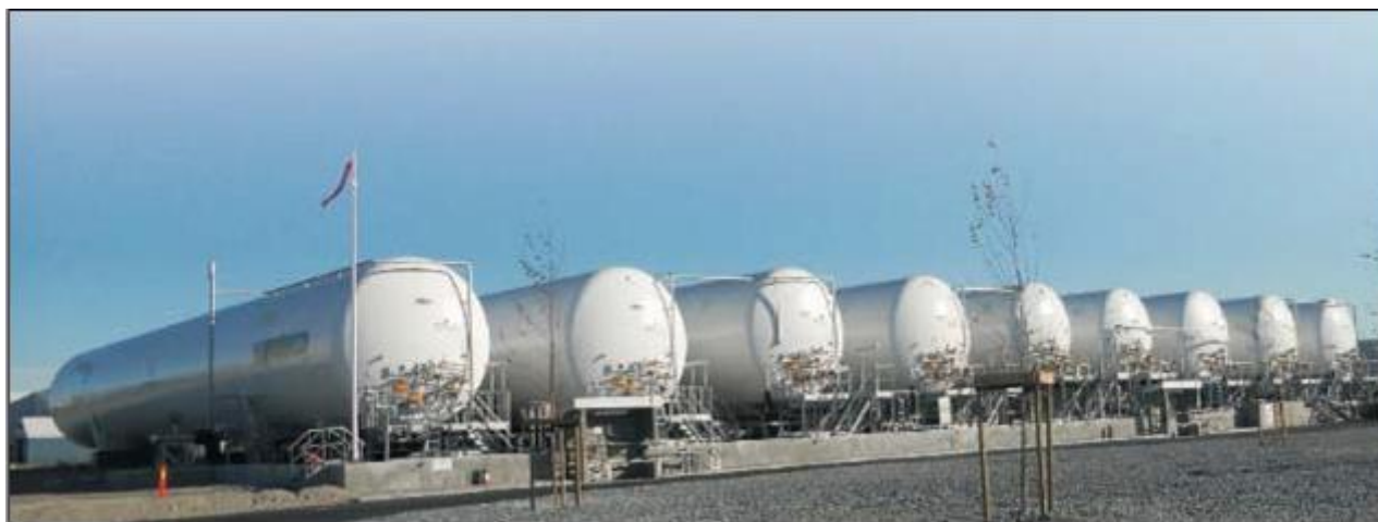
Figura 27 - Esempio di serbatoi criogenici (impianto GNL a Fredrikstad – Norvegia)
