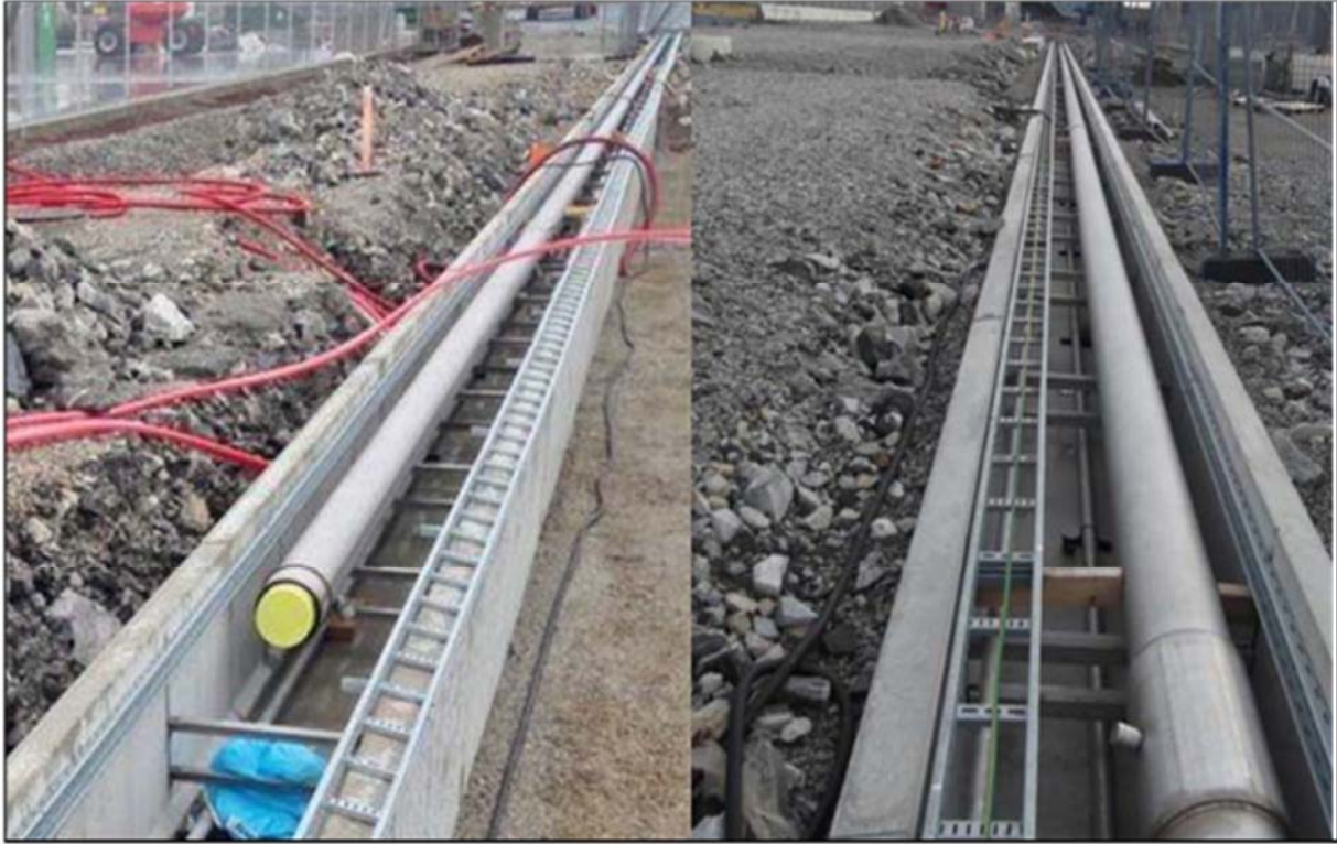
Figura 13 - Impianto di Risavika (Norvegia) - Cunicolo di passaggio tubazioni tipo VIP
