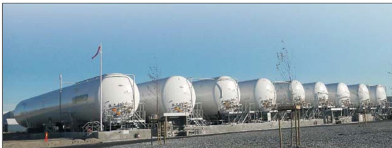
Figura 18 - Esempio di serbatoi criogenici (impianto GNL a Fredrikstad – Norvegia)
