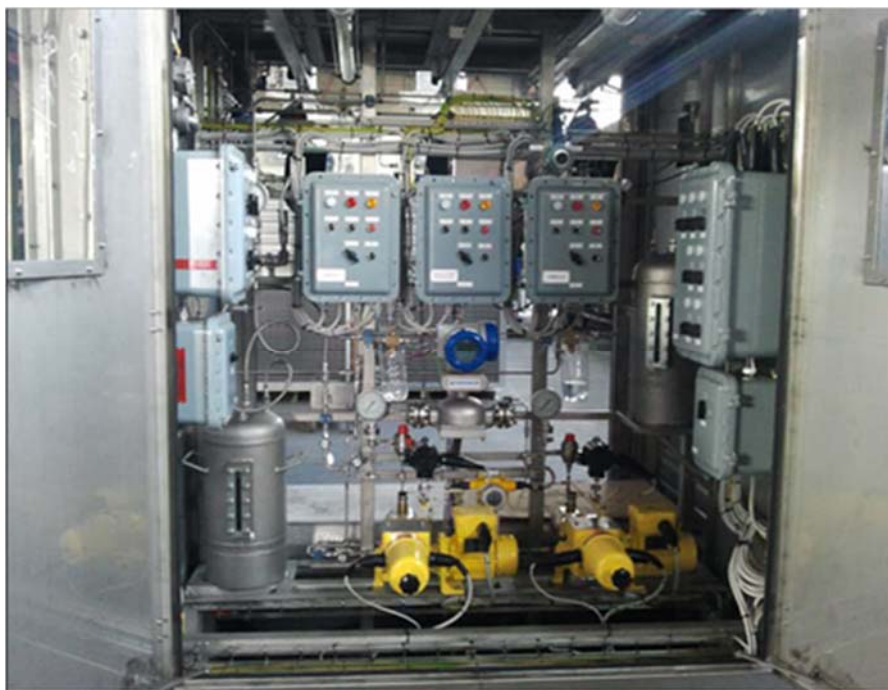
Figura 31 - Sistema di Odorizzazione
