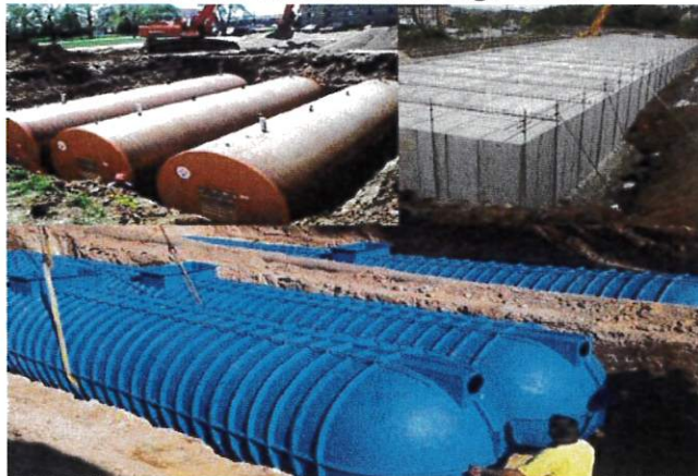
Figura 6-1. Opzioni di stoccaggio dell'acqua sotterraneo tra cui, in alto a destra, un esempio di serbatoio gettato in opera come previsto in progetto.
