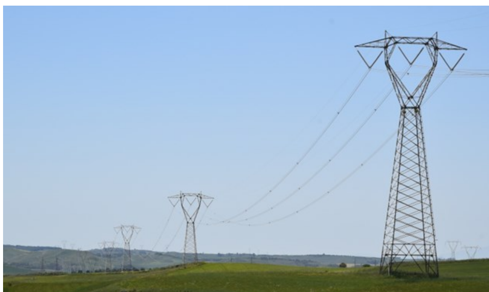
Figura 1.11: AAT Terna – Campagne di Sanluri - Sardegna
