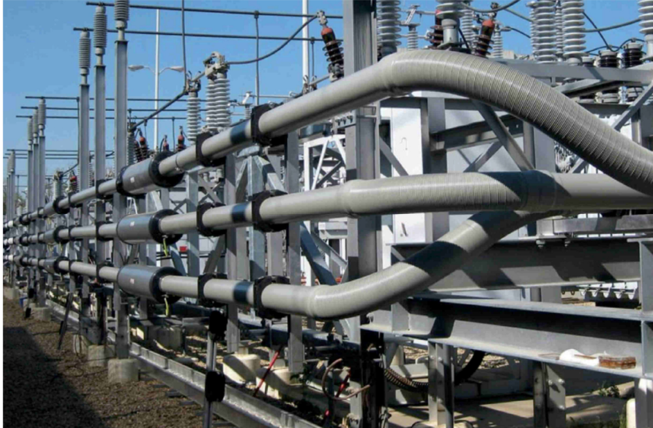
Figura 2 - esempio di installazione Sistema IPB (Isolated Phase Bus) – fonte: Duresca © Bus bar system (Moser Glaser)
